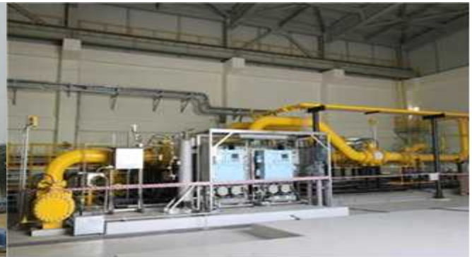
시운전 - Fuel Gas System
