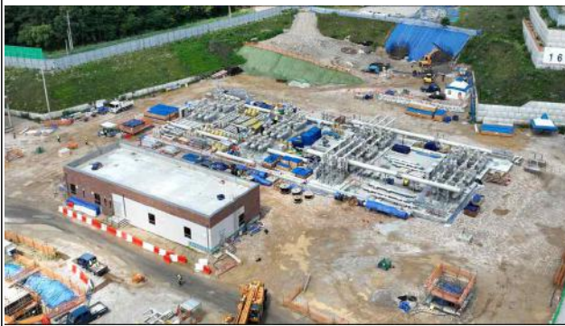
345kV GIS Area 전경
